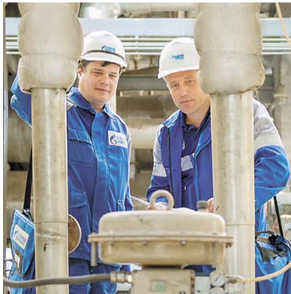
На установке ЭЛОУ АВТ-4 цеха № 18 смонтирован клапан-регулятор и прибор учета для контроля и регулирования расхода бензина
