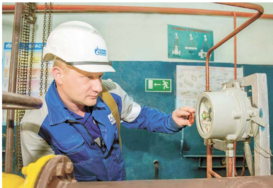
Проверка рабочего давления на манометре насоса, откачивающего продукт МТБЭ в резервуары
