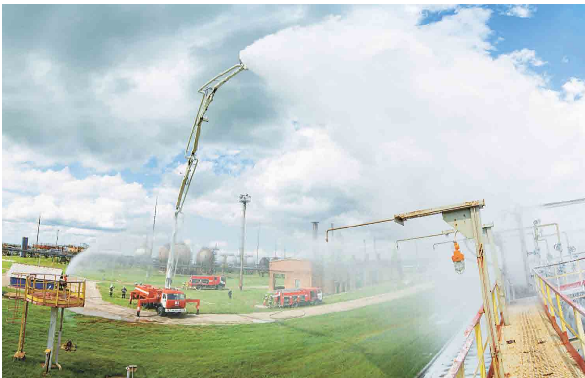
Автоматическая лафетная установка для тушения пожаров расположена по периметру эстакады
