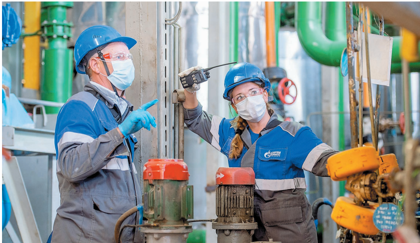
Регулирование расхода pH-корректора, при проведении фиксированного пробега на установке ХВО и ВОЦ
