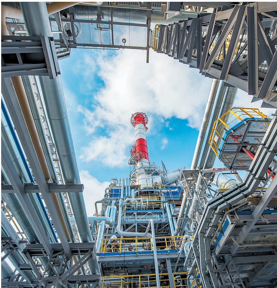
Установка построена по базовому проекту Foster Wheeler AG, Linde
