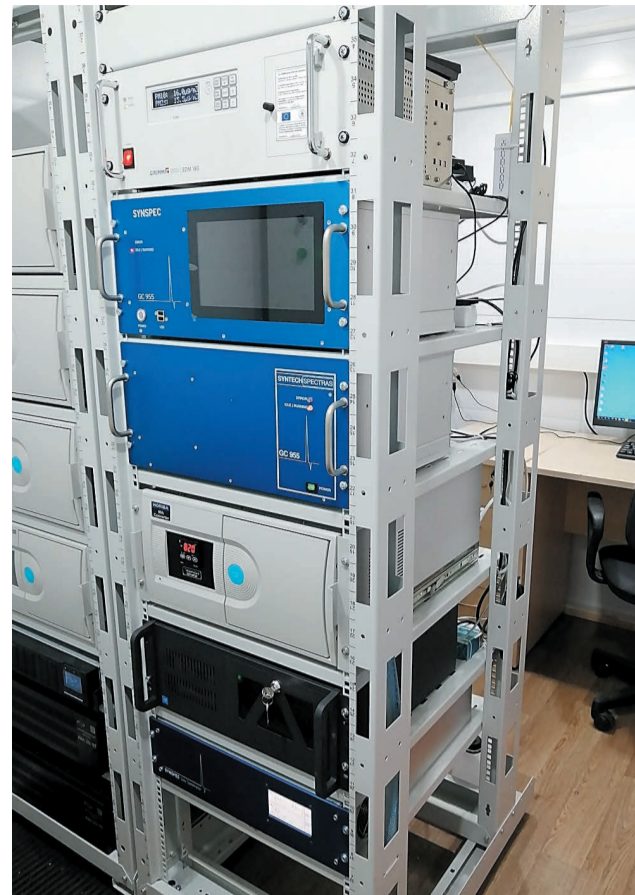
Станции оснащены современным оборудованием
