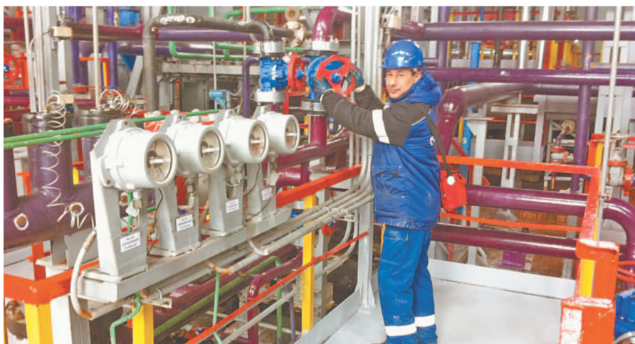
Новое оборудование устанавливается с учетом современных требований по безопасной эксплуатации опасных производственных объектов
