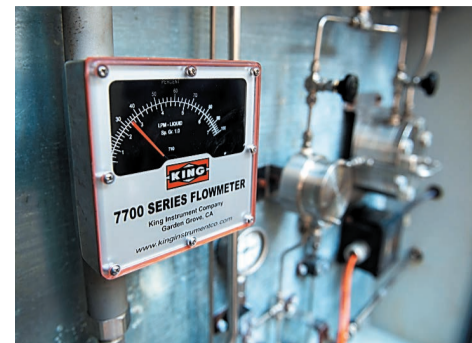
Часть системы подготовки пробы для поточного хроматографа
