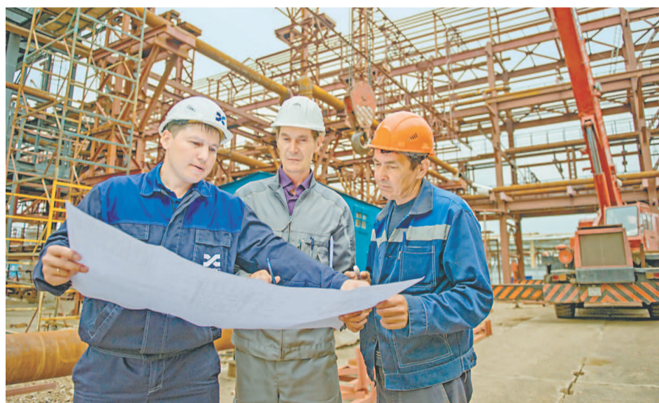
Оперативное совещание. Слева направо: главный специалист – координатор работ на строительной площадке ДКС ОАО «Салаватнефтехимремстрой» Рустам Каразбаев, мастер СМР ООО «СУ-44» Рафиль Литов, бригадир ООО «СУ-44» Гайса Якупов
