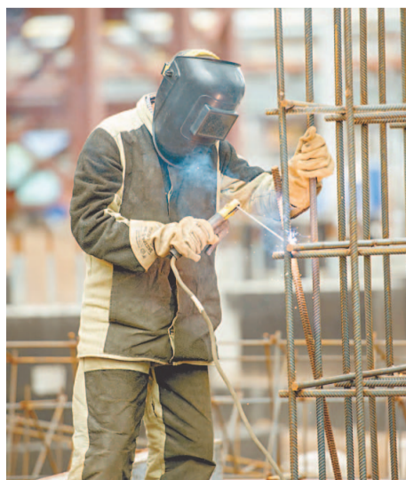
Электросварщик ООО «СУ-44» Ильдар Кираев на сборке арматурного каркаса фундамента компрессорных установок
