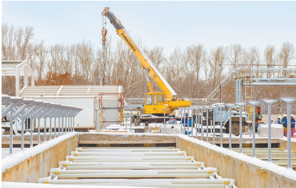
Обновленные очистные сооружения позволяют повысить качество очистки сточных вод и снизить потребление речной воды
