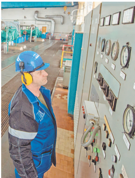
Отслеживание параметров по давлению углекислого газа на установке компрессии производства карбамида
