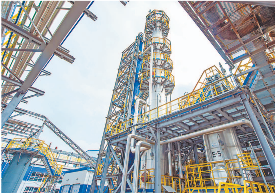
Пуск установки обезвреживания сульфидно-щелочных стоков вместе с происходящей глобальной реконструкцией очистных сооружений позволит сбрасывать в природный объект чистую воду 100-процентного качества
