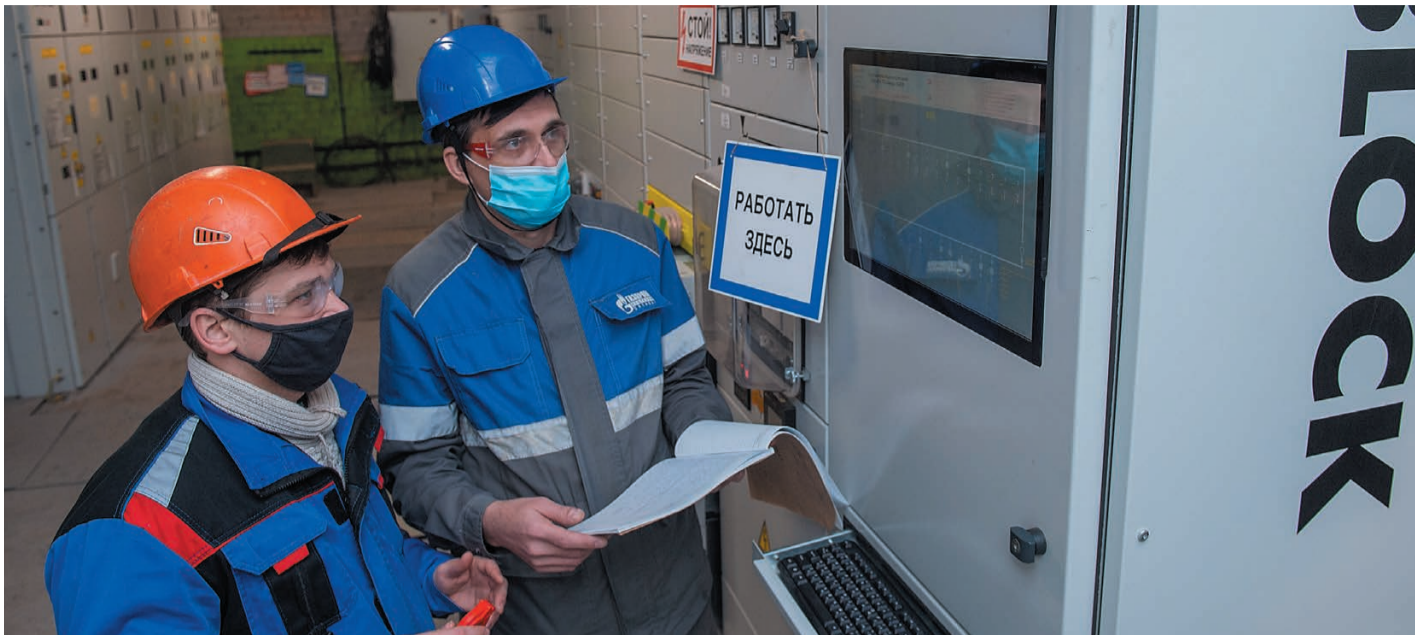
Новая трансформаторная подстанция уже в работе
