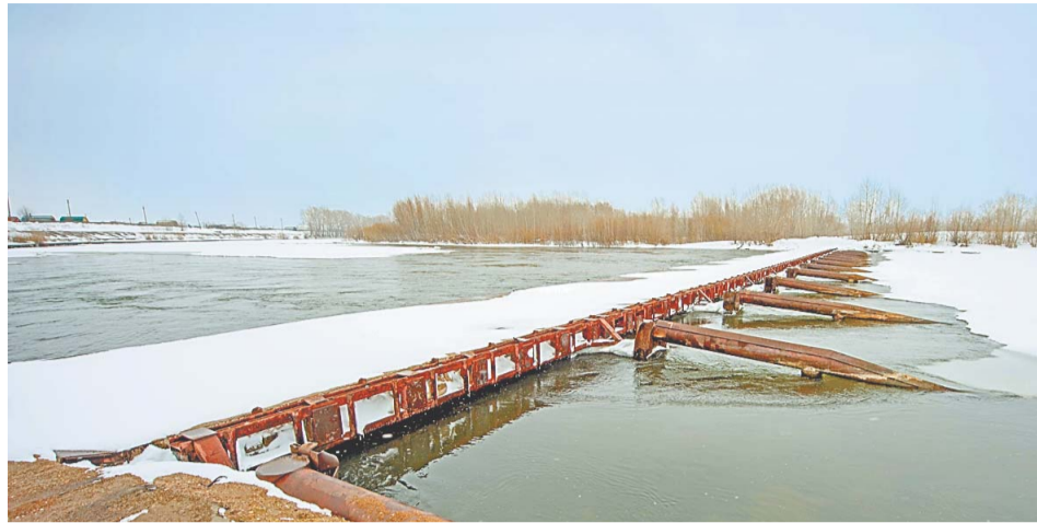
В периоды маловодья нормальное функционирование и бесперебойная подача речной воды обеспечивается водоподпорным сооружением шандорного типа
