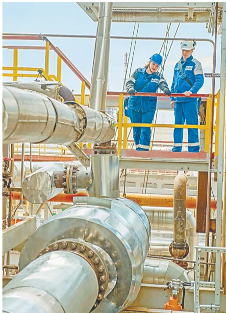
Сотрудники цеха № 51 ведут визуальный контроль работы нового технологического оборудования
