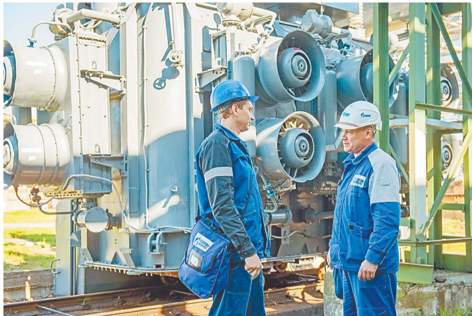
Силовой трансформатор является важнейшим элементом электрической сети
