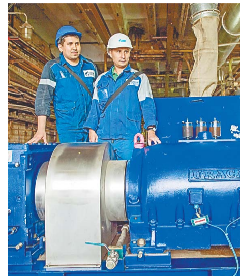
Современный насос фирмы URACA установлен в цехе № 24
