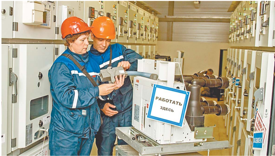
Ввод новой электроустановки – очередной шаг в развитии энергохозяйства Общества
