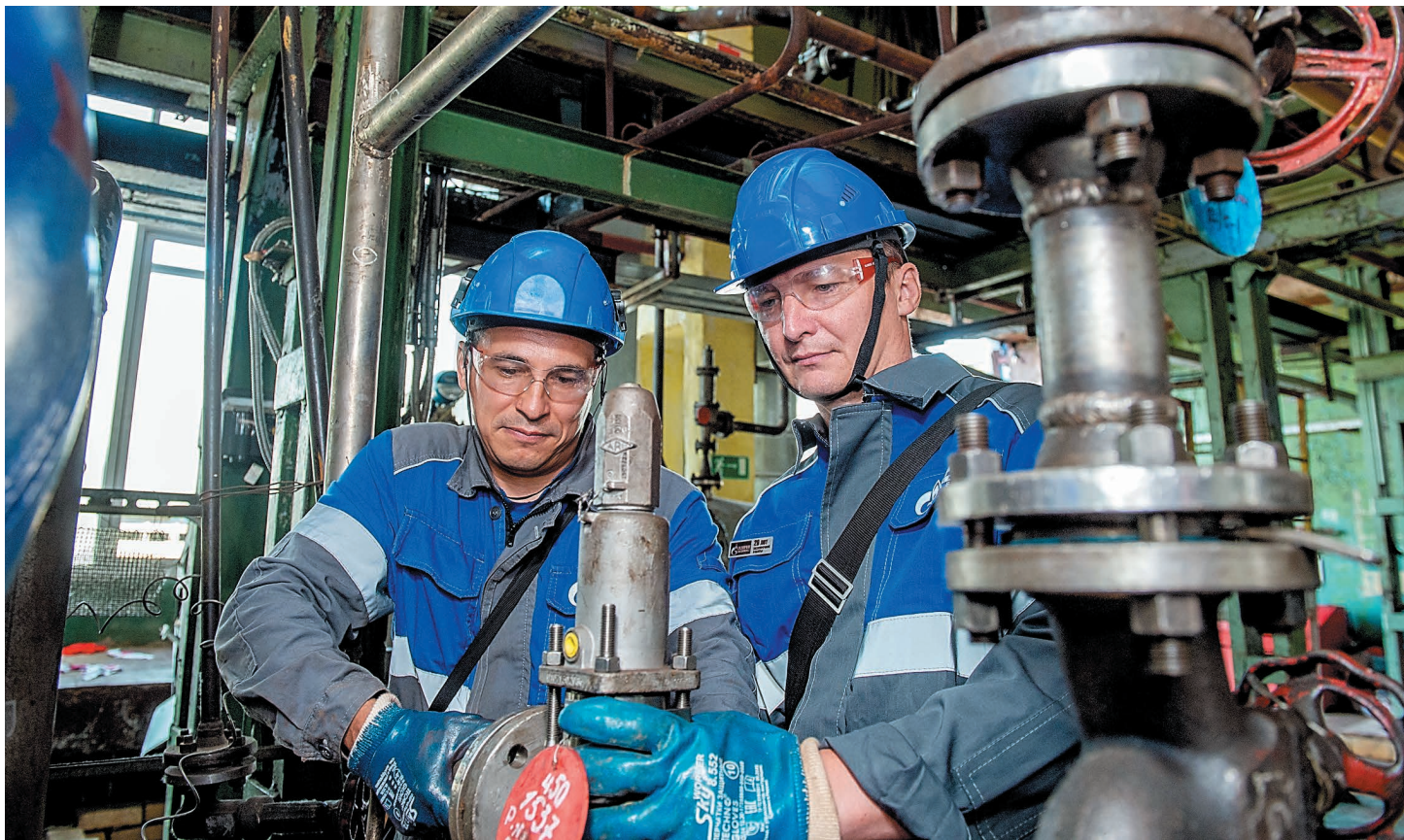
В рамках ремонта на ГХЗ предстоит выполнить работы по диагностированию и замене отбракованных участков, провести испытания оборудования, ремонт статического и динамического оборудования
