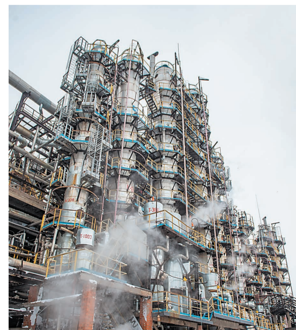
Установка ректификации ароматических углеводородов цеха № 58
