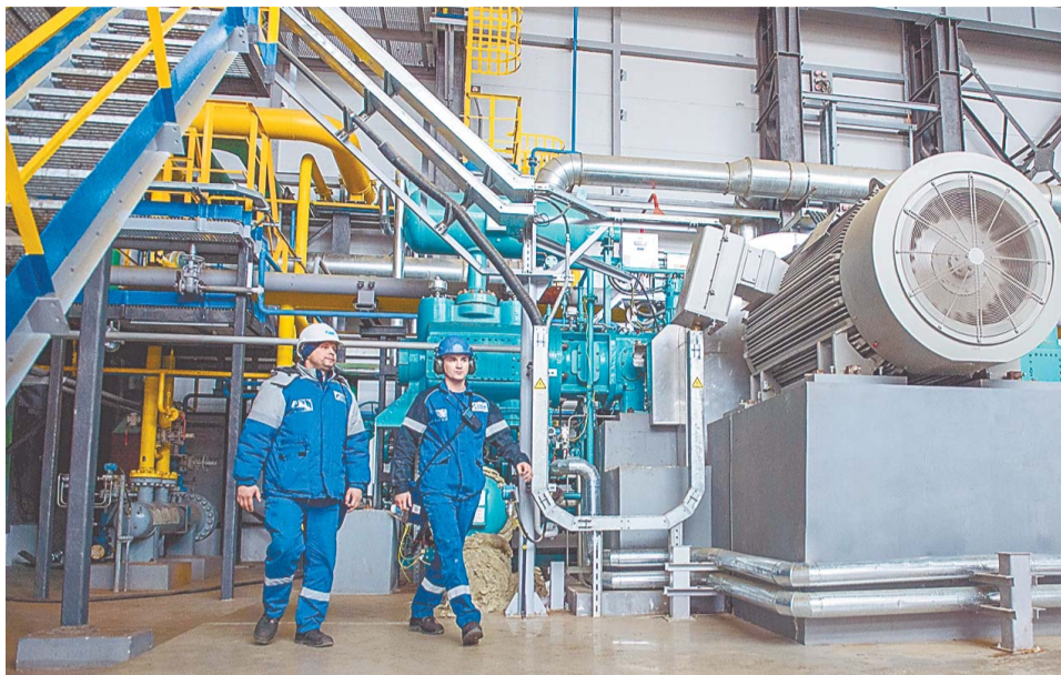
Блок КЦА полностью автоматизирован
