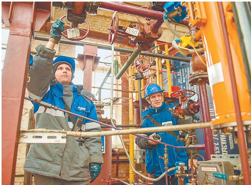
В насосной сероочистки установки ОГиКТ перекачивается абсорбент, предназначенный для очистки топливных газов
