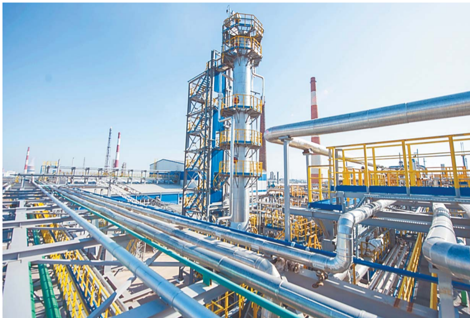
Близится к завершению строительство установки по обезвреживанию сульфидно-щелочных стоков мощностью 438 тыс. т/год
