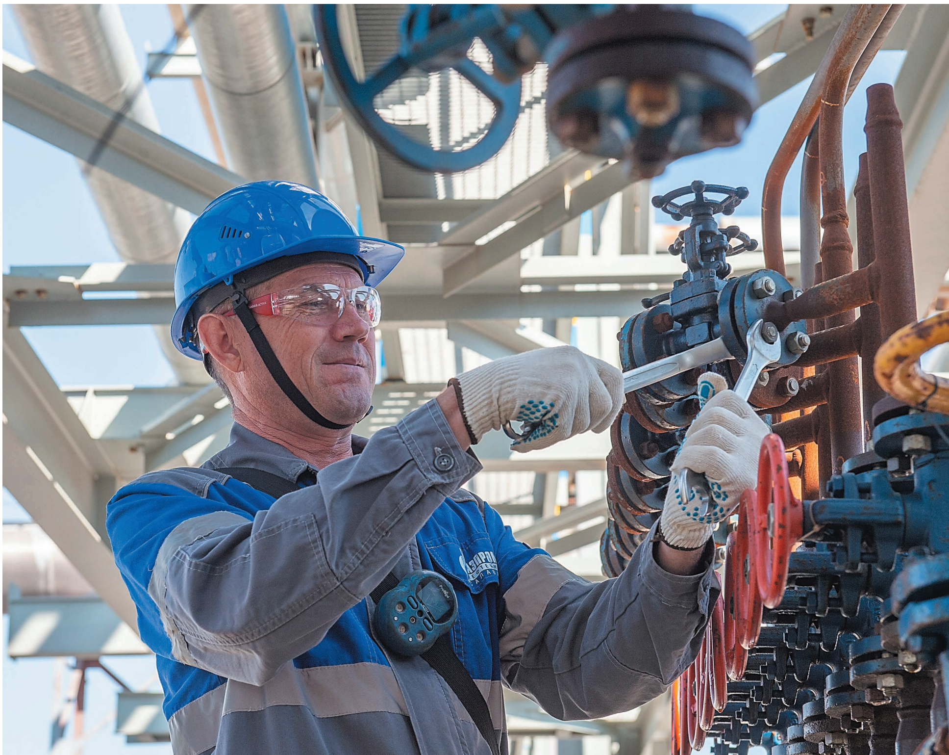
Оператор технологических установок Халит Искандаров производит наладку отопительного коллектора
