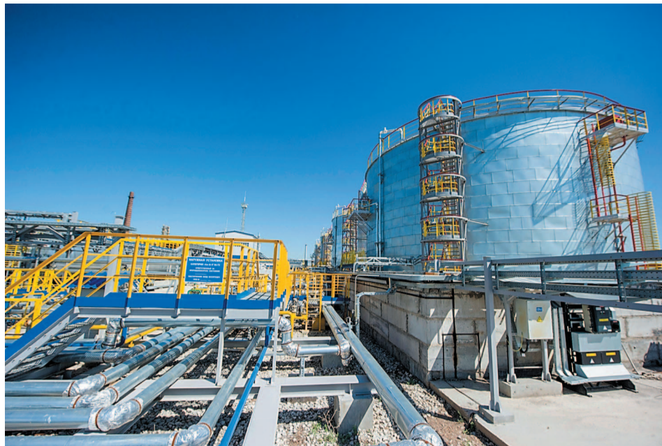
Резервуары нового блока ФОС
