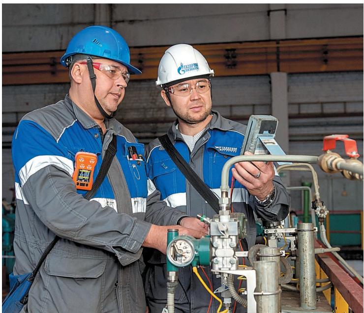
Приборист участка № 3 по обслуживанию КППиА Максим Волков и начальник участка № 3 Андрей Клеин
