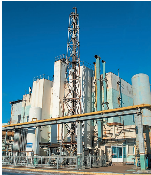
Воздухоразделительная установка, объект 273
