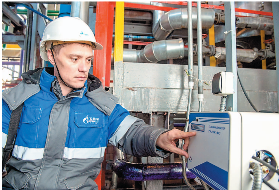
17 датчиков открытого и закрытого типа установлено в ЕСК
