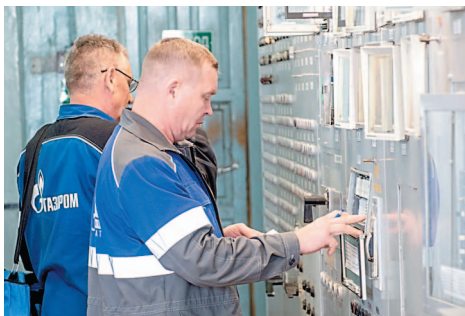
В операторной цеха
