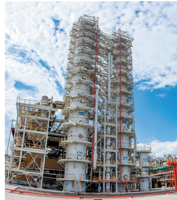
Цех № 51, колонны абсорбции и десорбции
