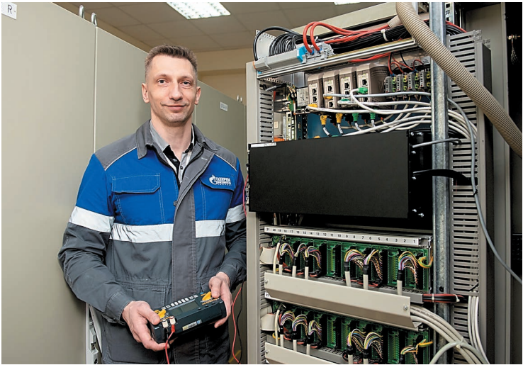
Проверка входных измерительных каналов
