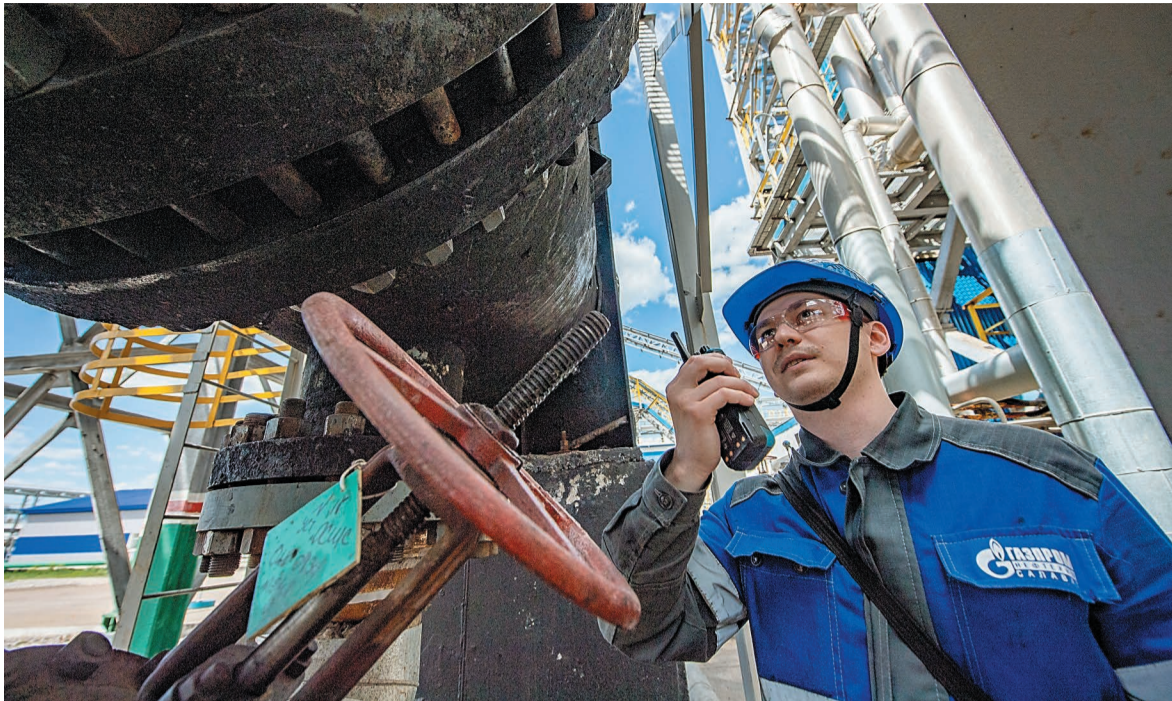
Цех №18, установка очистки сульфидно-щелочных стоков
