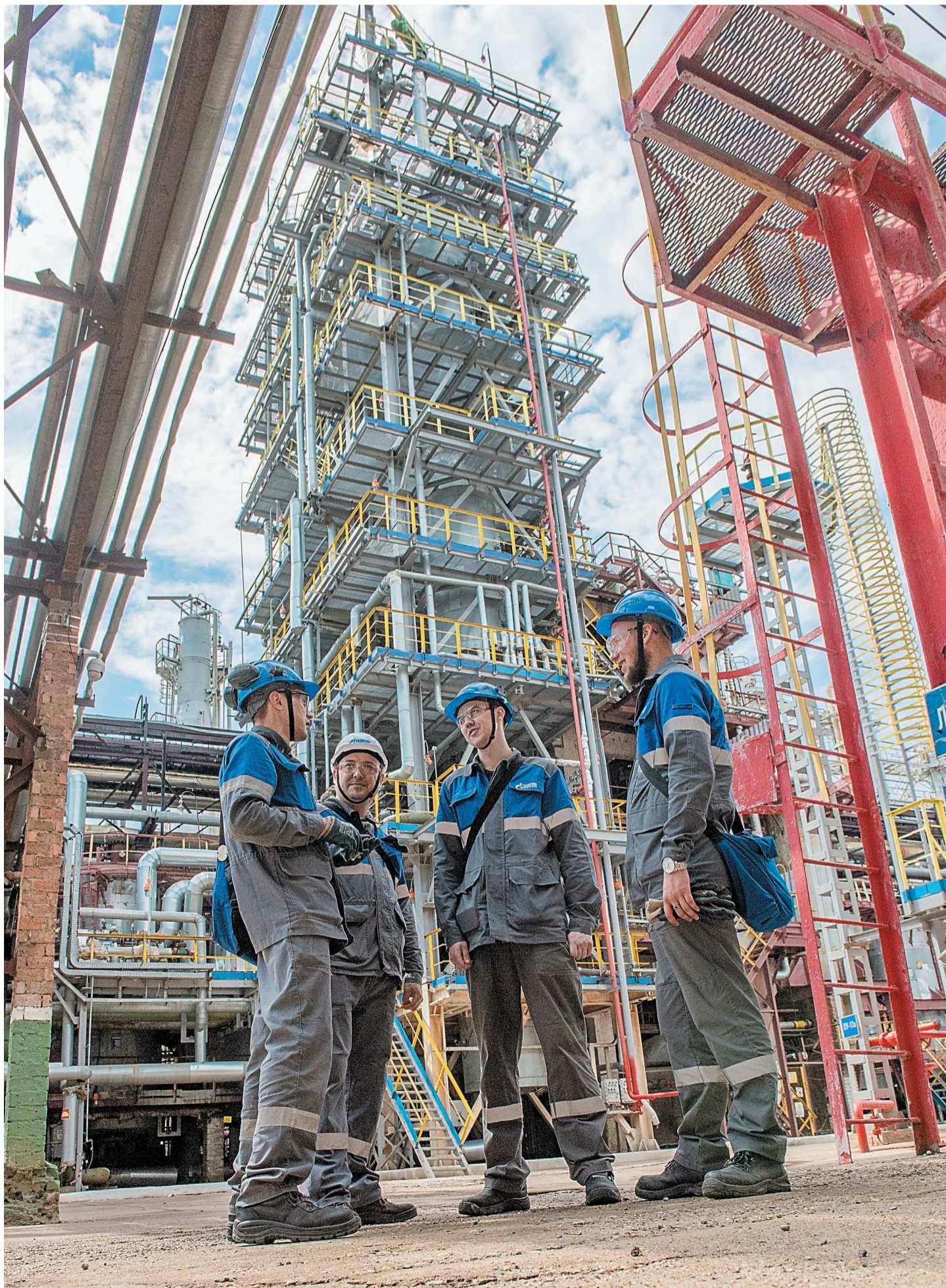
Цех № 56, установка газоразделения, реакторный блок гидрирования ацетилена
