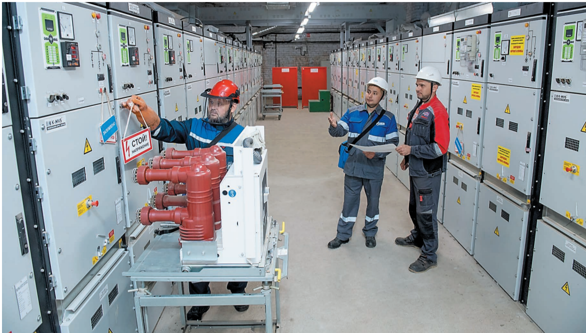
В обновленной подстанции ГПП-5
