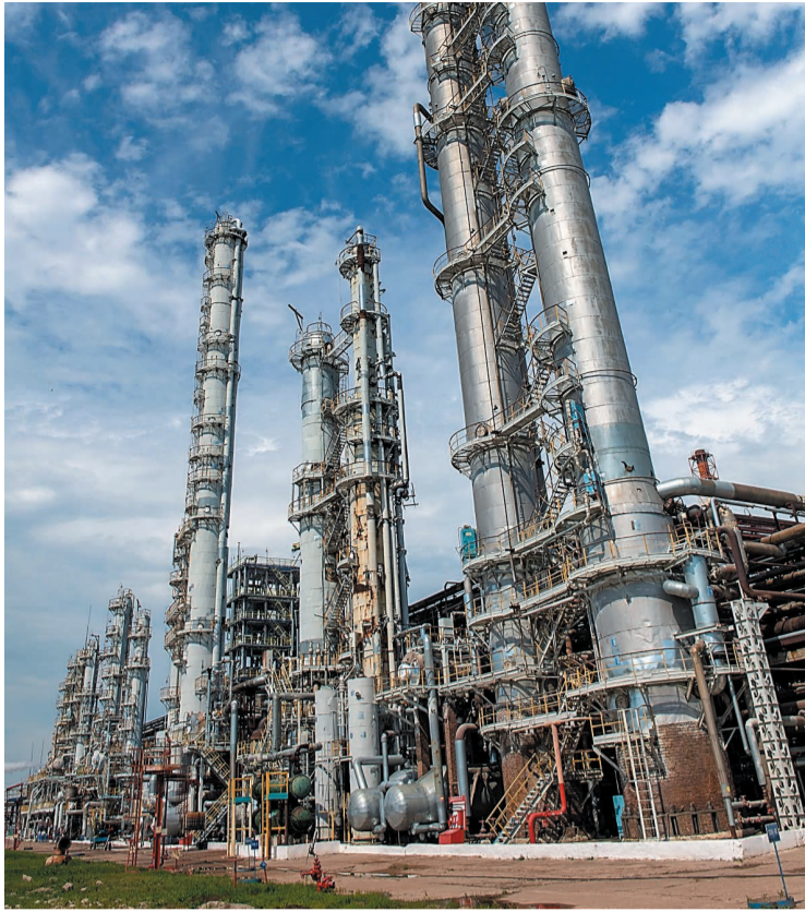
Колонный ряд установки газоразделения
