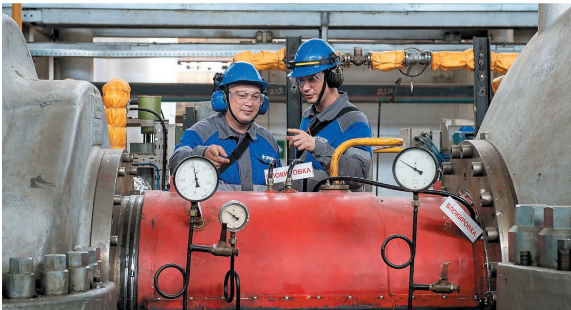
Машинный зал установки компрессии, компрессор поз. М-1
